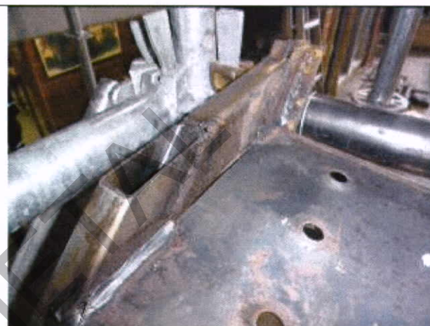
Fotografía 4.2.2: Detalle de la zona de soldadura de las diagonales al escalón cargado. Lado oriente.
