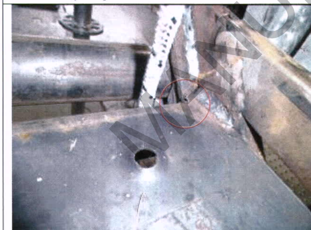
Fotografía 4.2.3: Detalle de la zona de soldadura de las diagonales al escalón cargado. Lado poniente
