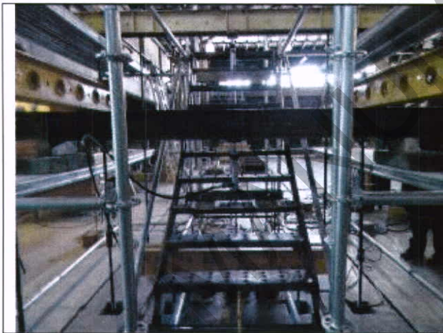
Fotografía 4.3.1: Vista frontal de escalera cargada a los cuartos donde no se aprecian mayores deformaciones de los peldaños.
