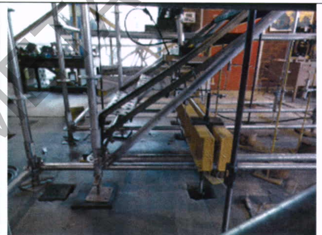
Fotografía 2.4: Vista lateral de las diagonales que unen los peldaños longitudinalmente a la escala.
