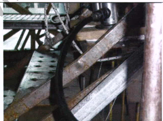
Fotografía 4.1.2: Detalle de la diagonal superior pandeada por deformación flexural en el centro del vano de la escala.
